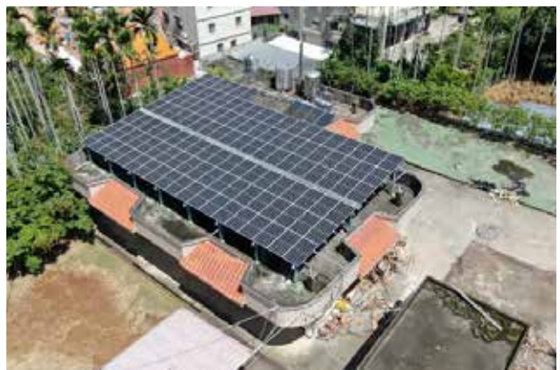
草屯鎮坪頂國小 裝置容量：39.6kW(瓩) 併聯日期：110.9.2
