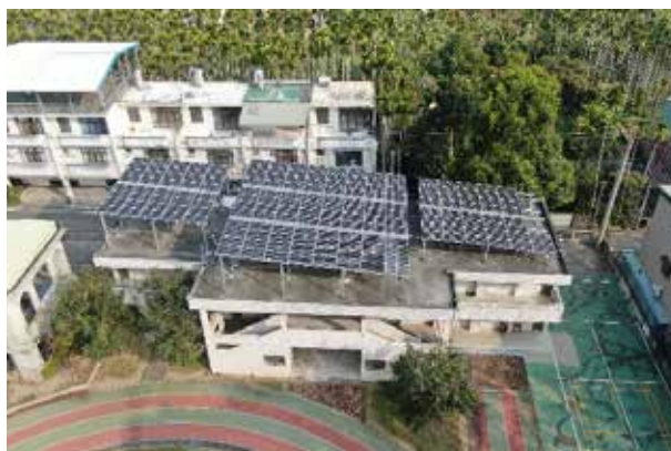
南投縣集集鎮隘寮國民小學 裝置容量：58.74kW(瓩) 併聯日期：110.1.20
