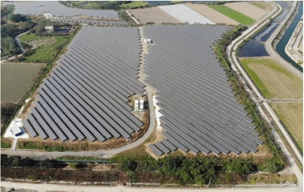
臺南垃圾掩埋場土地太陽能光電設備
