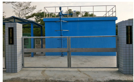
送水到偏鄉(梅嶺加壓站)
