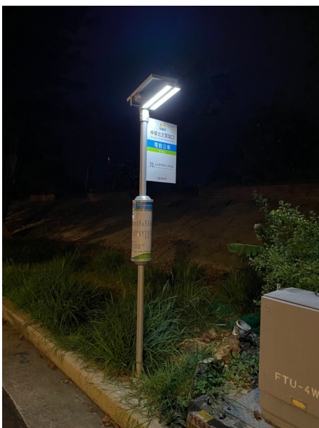
新式站牌太陽能照明設備
