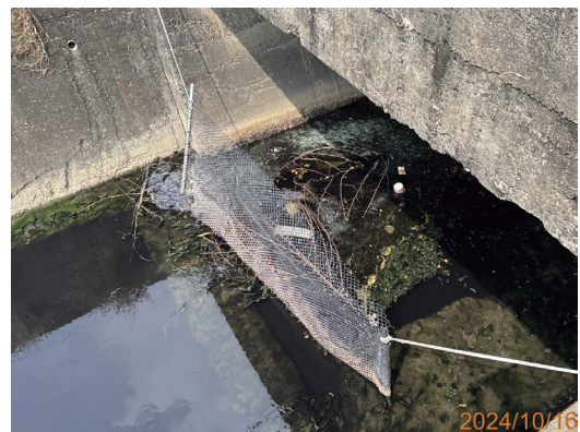
河面垃圾攔污網垃圾堆積情形
