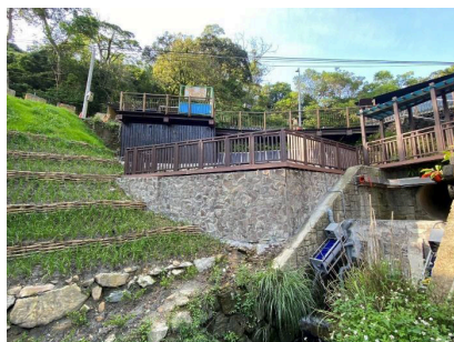
白石湖美麗田設置「聚落式污水處理設施」
