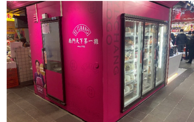
南門市場攤商汰換節能冷凍庫設備
