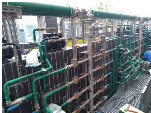
用戶屋頂分表位置安裝智慧水表及傳輸設備
