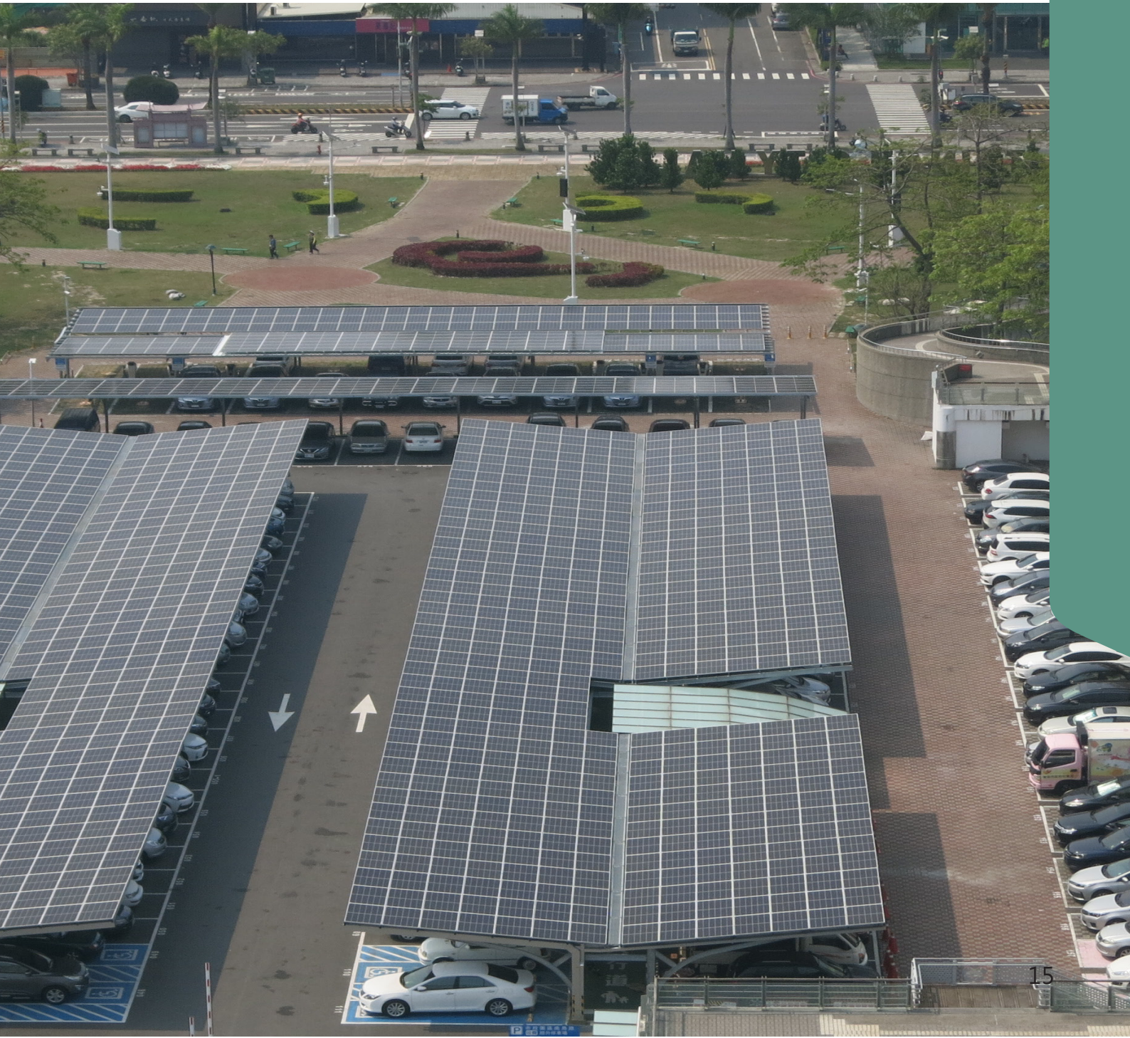
永華市政府府停車場太陽光電板屋頂
