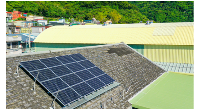
獅子鄉南世部落防災型微電網避免孤島效應
