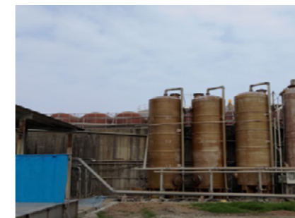
畜牧場廢水設施，資源化再利用
