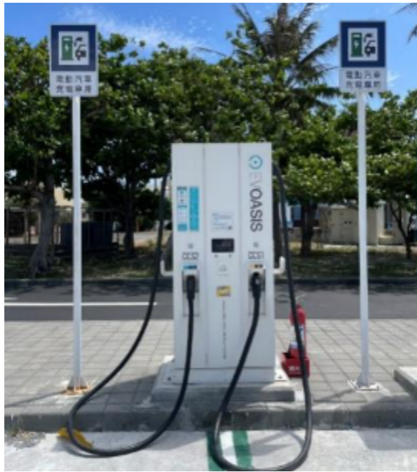
海口港休閒專用區停車場充電樁
