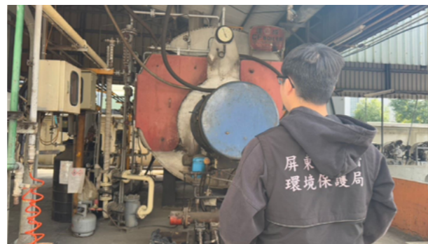
工業鍋爐汰換
