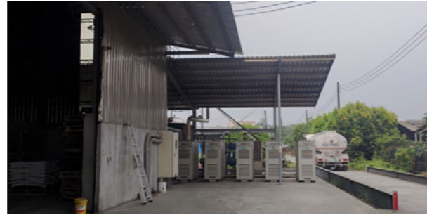
畜牧場沼氣發電設備
