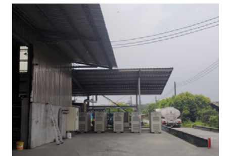
畜牧場沼氣發電設施，提升能源自給率
