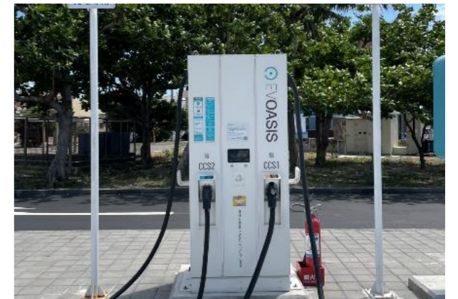
海口港休閒專用區停車場充電樁
