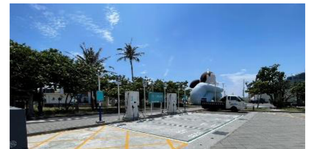
海口港休閒專用區停車場充電樁
