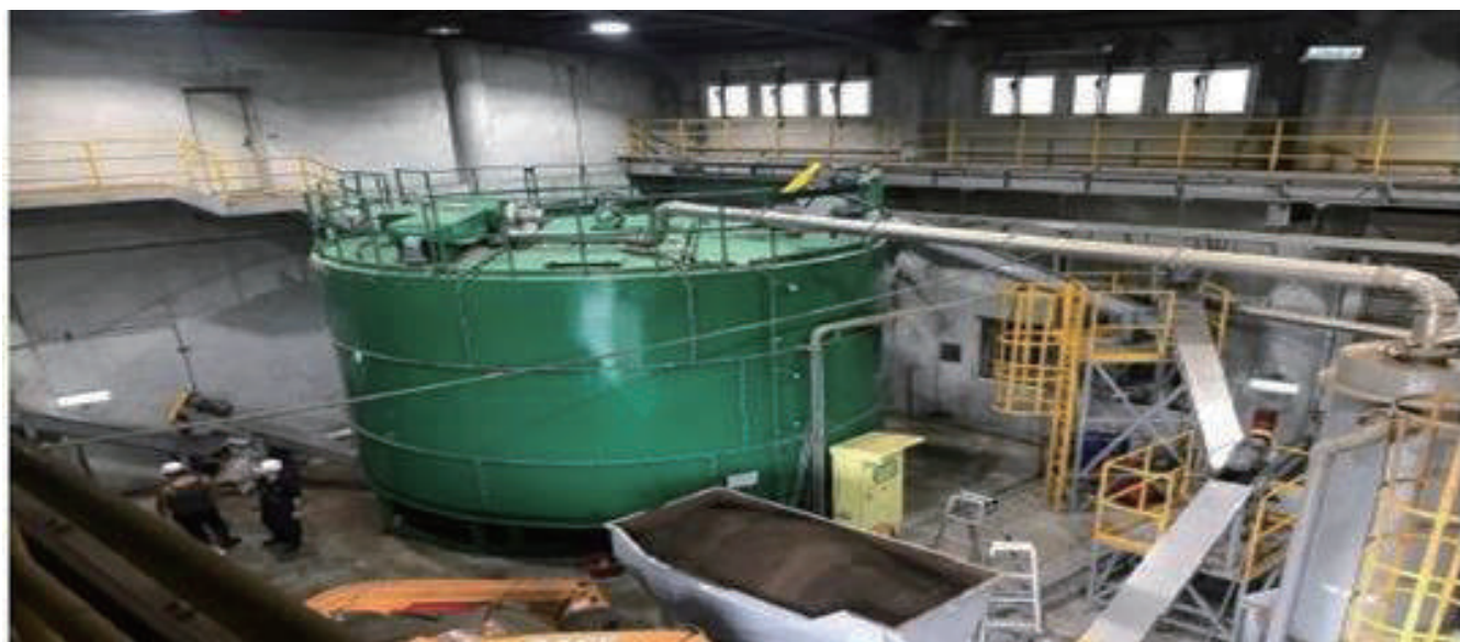
▼利澤廚餘廠設備—高速發酵槽
