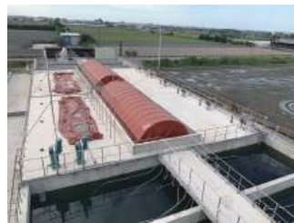
轉型後之廢水處理設施
