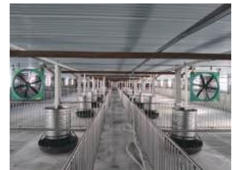
密閉式高床豬舍及排風設施
