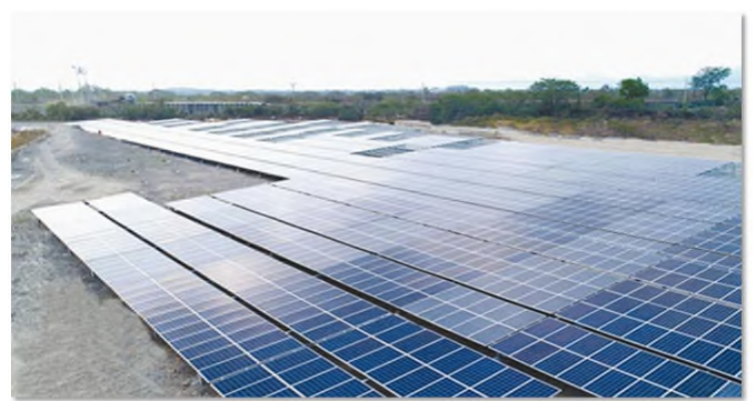
圖 3-16 屏東縣高樹鄉國有土地改良利用案-太陽光電設施開發案
