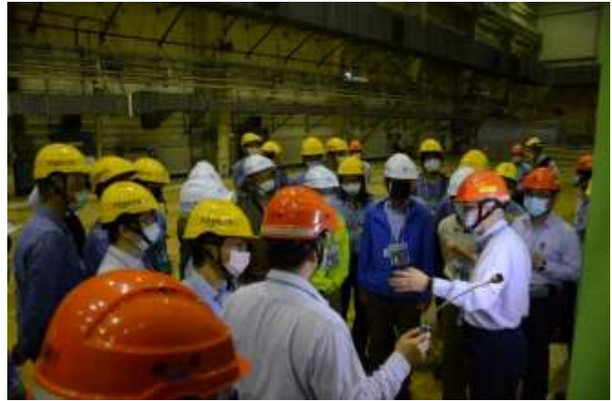
圖 6 原能會審查小組 110 年 3 月 12 日執行核一廠汽機廠房設備拆除區域現場視察(二)
