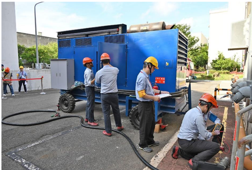
圖35、核三廠移動式電源車列置與引接演練
