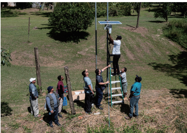
▲圖 2-37 駐貝里斯技術團「貝里斯河流域水災預警能力提升計畫」派遣專家指導貝國技術人員維修水文觀測站設備
