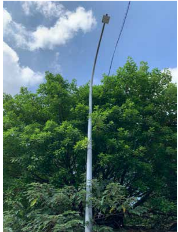
延平路1段118巷內，汰換LED85W燈具
