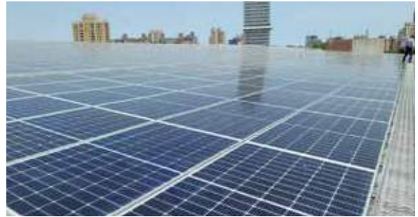
新竹市立體育館裝置光電發電設備
