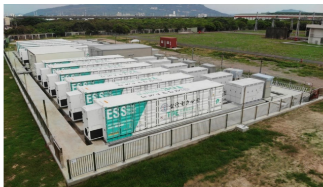
台電路園變電所儲能系統裝置容量達 20MW
